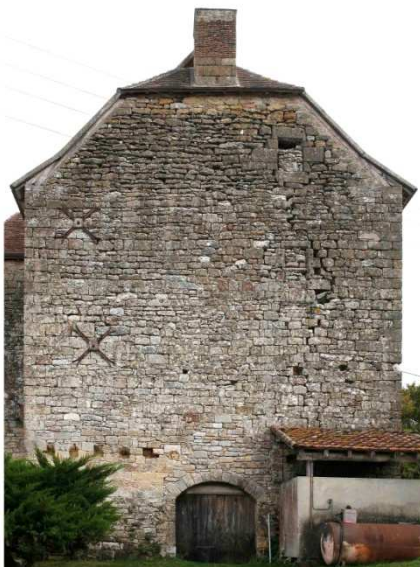
Mur ouest de la maison forte : deux baies murées sont traversées par une fissure
