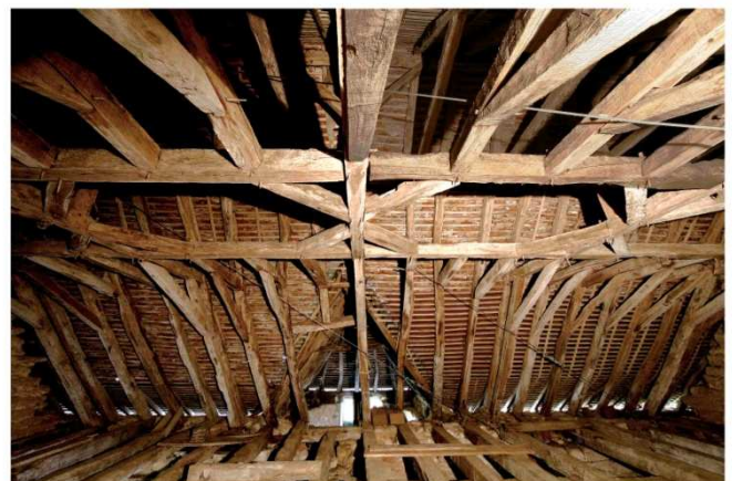
Versant nord de la charpente On remarque le basculement vers l'ouest sur l'arbalétrier du milieu
